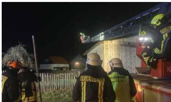
Kameraden der FFW Wasserleben sichern zusammen mit der FFW Ilsenburg lose Dachflächen. Foto: © Feuerwehr Wasserleben
