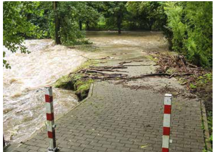
Beim Hochwasser im Juli 2017 ist die Ecker über das Ufer getreten und hat die komplette Köhlerbrücke überspült.
